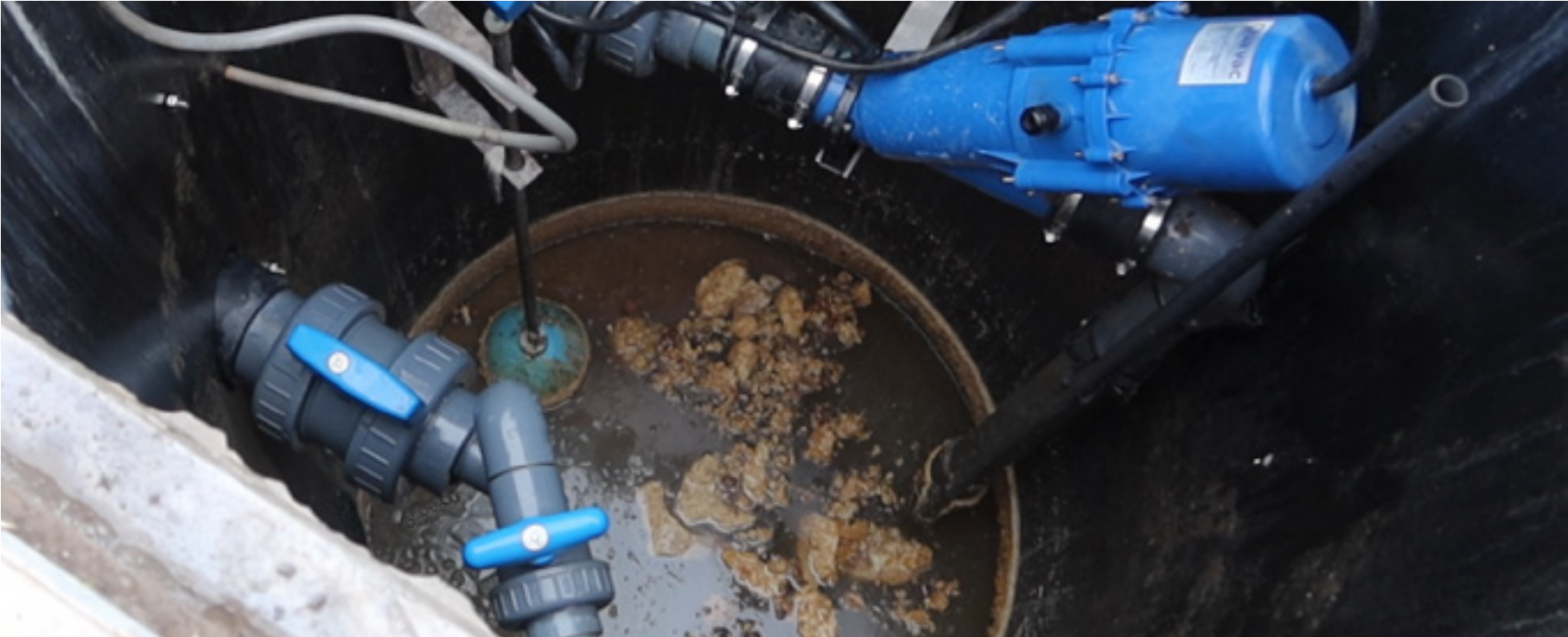
In het buitengebied staan drukrioolunits bij de woningen. Hier wordt het afvalwater van één of enkele woningen en bedrijven ingezameld. Het wordt daarna onder druk in een kleine persleiding getransporteerd naar een nabij gelegen stad of dorp.
