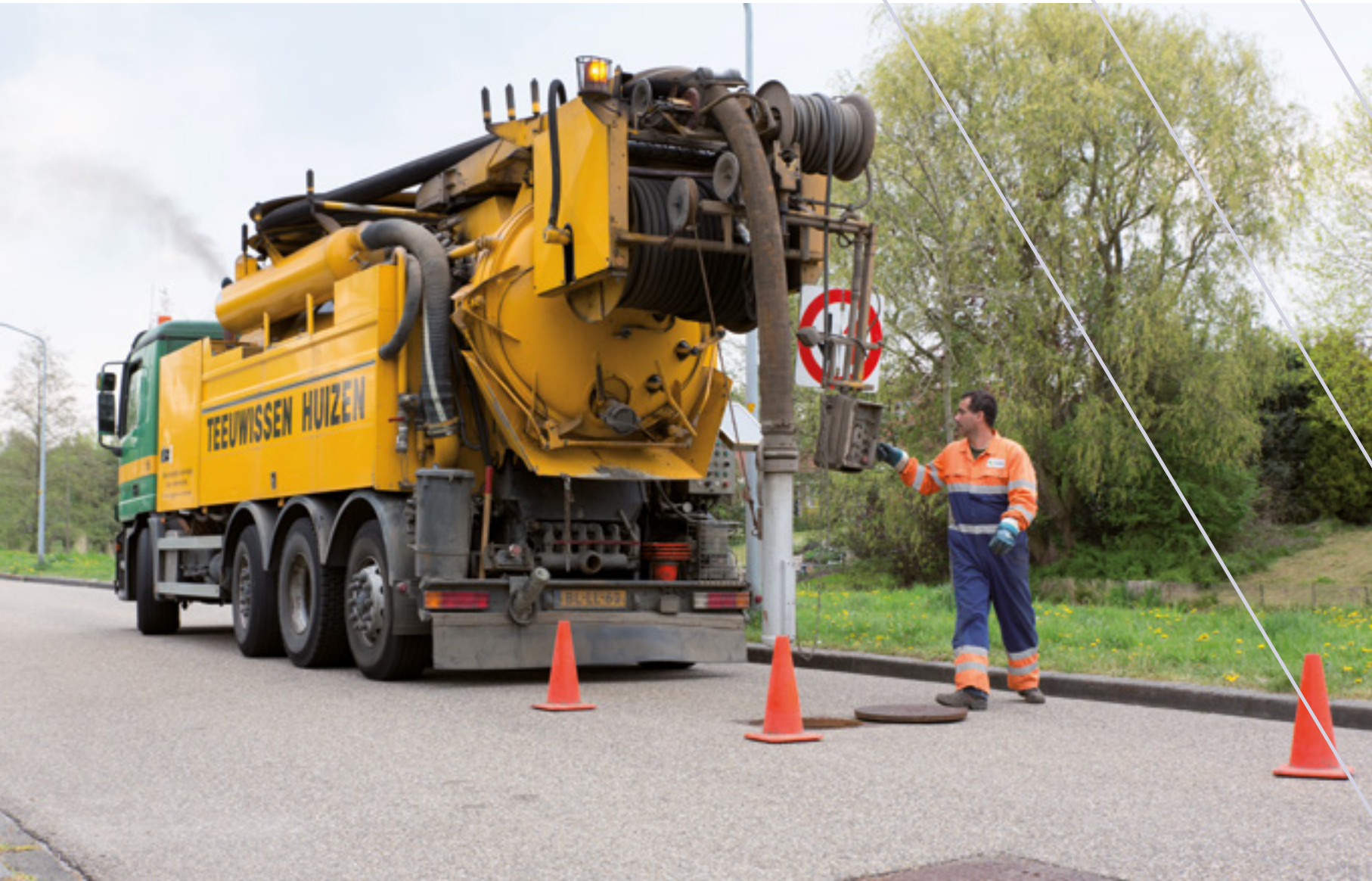
Kolken en goten zijn de entree voor hemelwater naar de riolering. Afstromend hemelwater neemt straatvuil mee. Dit bezinkt grotendeels in de bak van de straatkolk en moet af en toe worden verwijderd.
