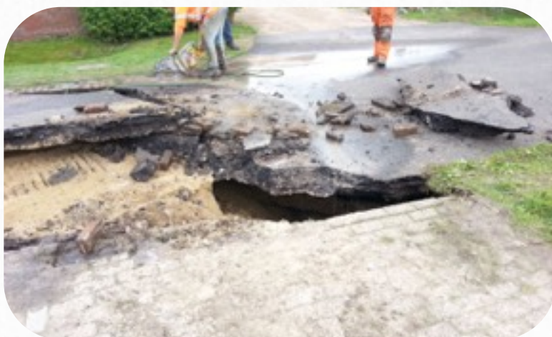
foto van een calamiteit in Marienvelde nabij rioolgemaal
