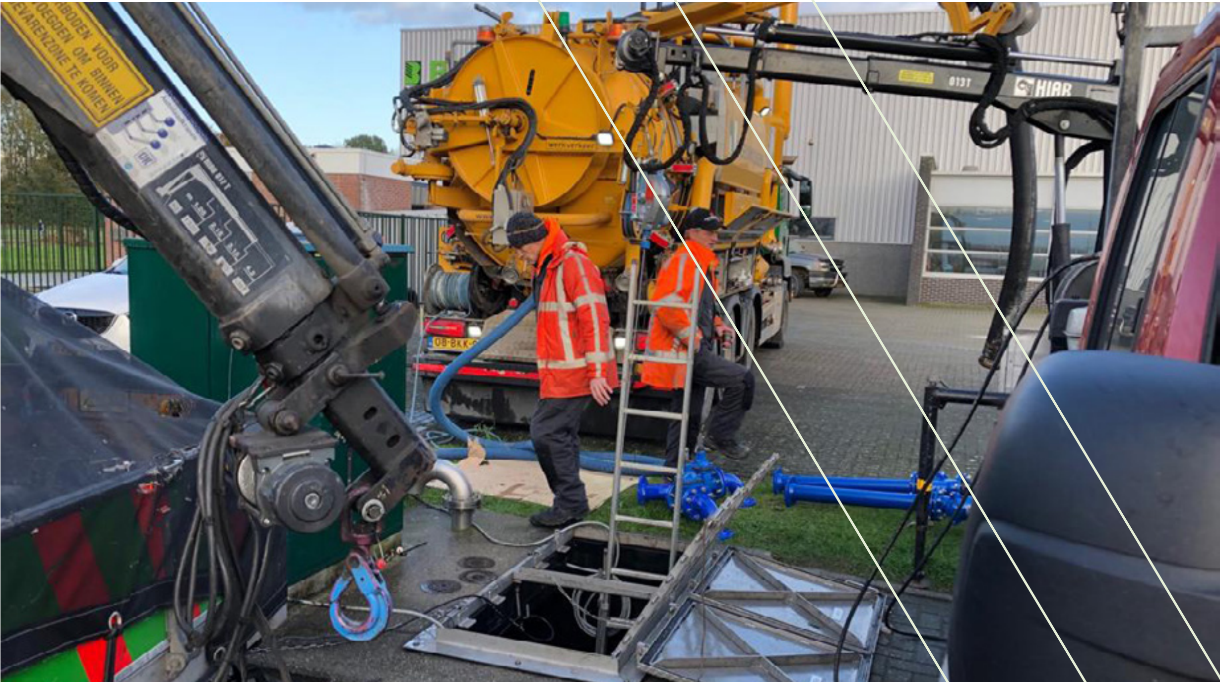
Door rioolgemaal op tijd te renoveren blijft de bedrijfszekerheid gegarandeerd. Hiermee behouden we een robuust systeem voor de afvoer van afvalwater.
